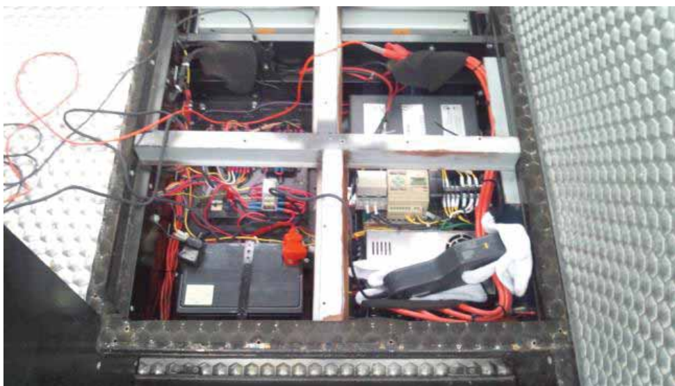
図 4.2-3 モーターとバッテリー間のケーブルからの電力測定
