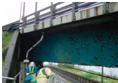
鋼橋の発錆 （国道8号 青海跨線橋）
