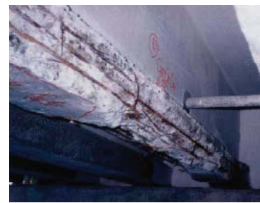
鉄筋・P C鋼材腐食 （国道8号 筒石橋）
