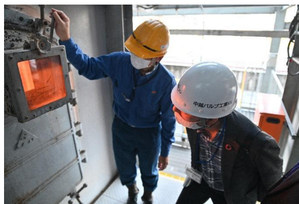
図 6.3-4 燃焼状態を目視する小窓
