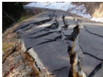
亀裂が入った道路
