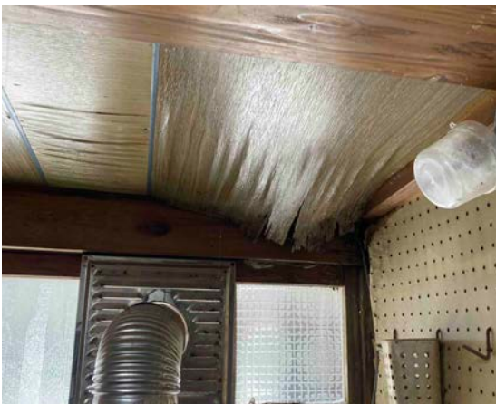
ボイラー上の小屋根が雨漏りしている状態だった
