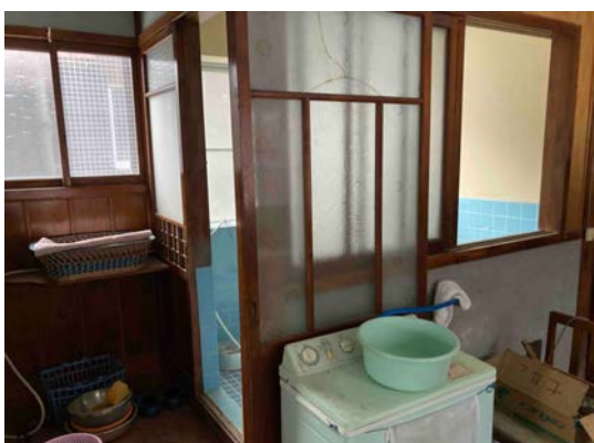
風呂場の仕切りは木枠のガラス窓で特に冬場は寒い状況
