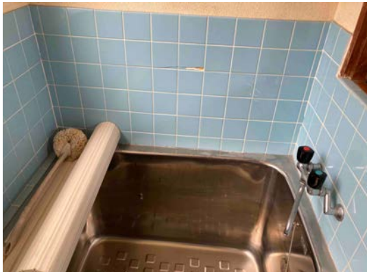
風呂場のタイルが一部破損していた
