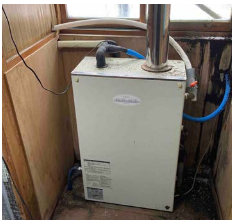
ボイラー周りの板材も雨漏りの影響を受けていた
