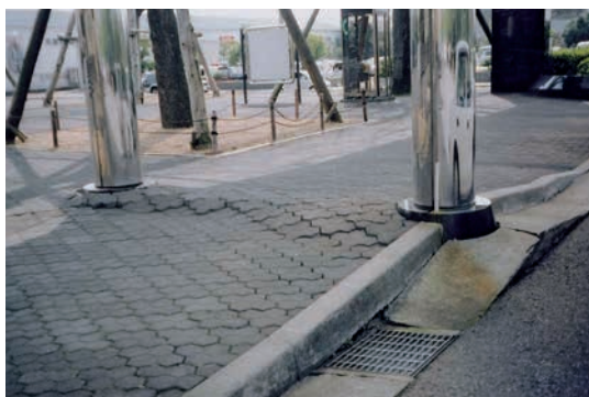
図2 腐植土層の沈下で抜け上がった支柱 (新潟県立自然科学館タクシー乗り場、修復前)
