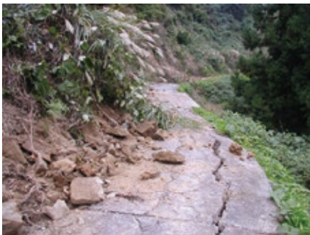
中越地震で崖が崩れた池谷集落の道路
