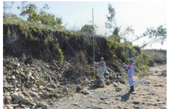
被災状況の調査（千曲川支川 夜間瀬川）
