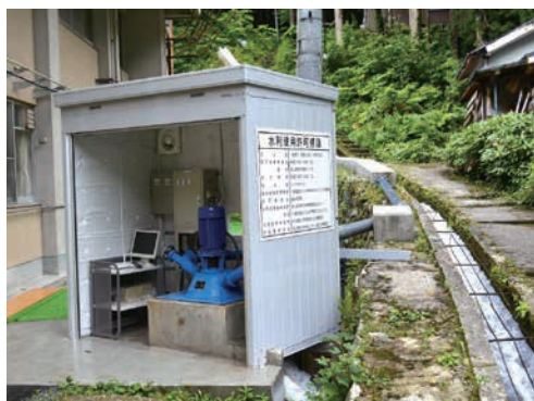
小水力発電所「でんきウォー太郎」
