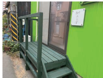
銅屋小路に面した図書館 出入口となるウッドデッキが完成
