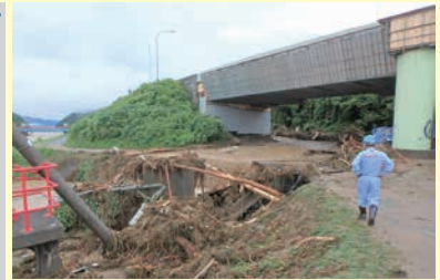
荒川被災箇所の現地確認
