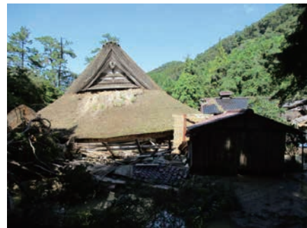
地震で倒壊し、1、2階部分が潰れて屋根が地面に着いてしまった上時国家主屋
